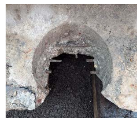
Foto-9 Beschadigde voorspanstrengen t.p.v. hijsgat
