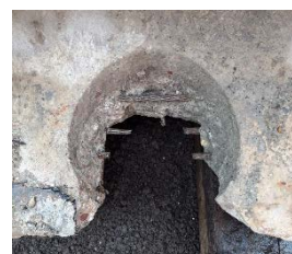
Foto-9 Beschadigde voorspanstrengen t.p.v. hijsgat
